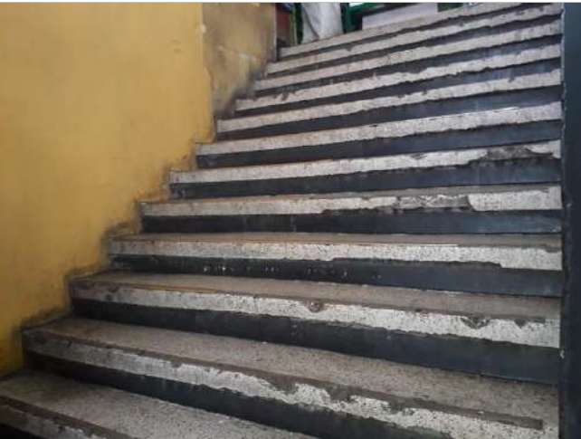
Fotografía N° 13 Antes pisos zona escaleras PMD Restrepo
