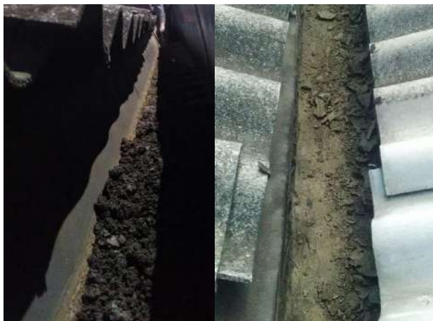
Fotografía N°7 Canales estado inicial.
