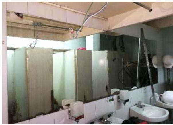
Fotografía N° 11 Baños centrales estado inicial.
