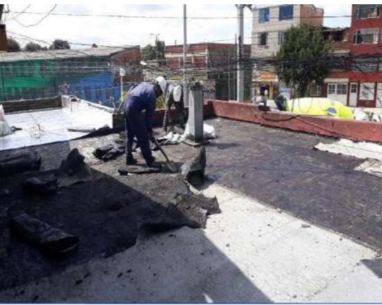
Fotografía N° 17 Antes cubierta PMD Las Quirigua.
