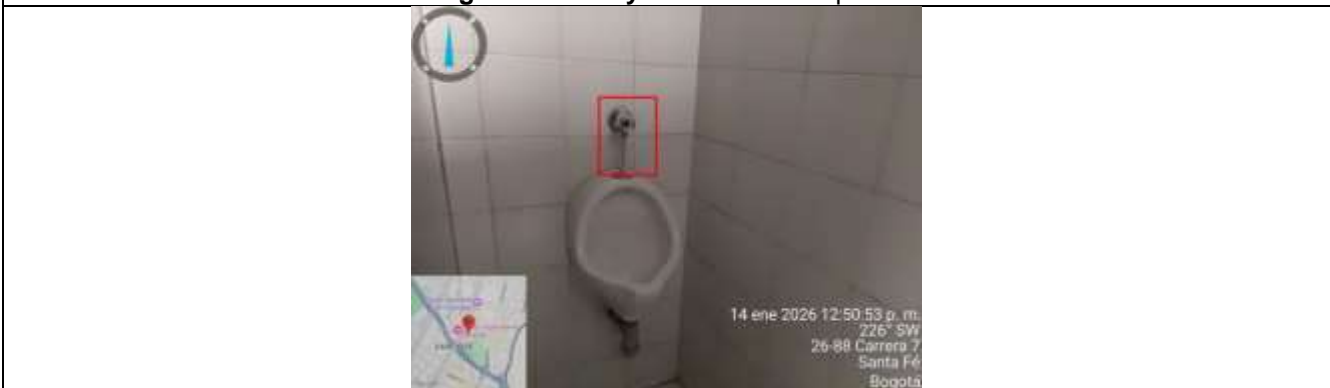
Fotografía No. 3. Sistema ahorrador instalado en un orinal del equipamiento
