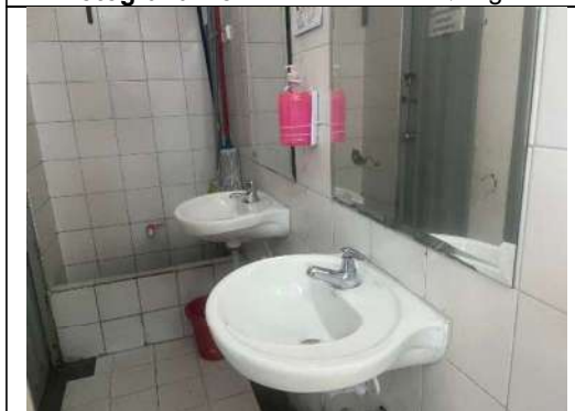
Fotografía No. 3. Lavamanos convencionales
