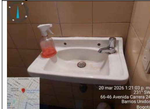
Fotografía No. 3. Lavamanos convencionales
