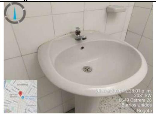
Fotografía No. 4. Lavamanos convencionales
